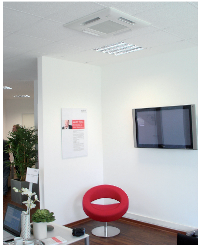
Hitachi 4-Wege-Decken-kassettengeräte Euro-Raster für die Büroräume der Hitachi Medical Systems GmbH.
