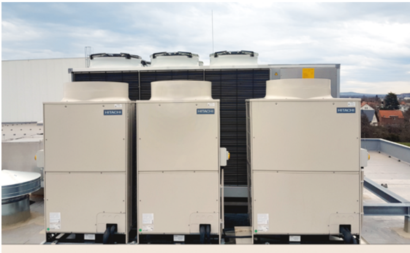
Bildquelle: Yves Schirmer Kälte-Klima-Wärmepumpen
